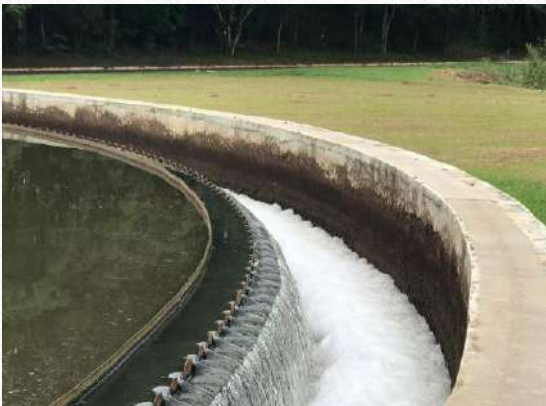
Estação de tratamento de Efluentes ETE – Dr. Hélio Seixo de Brito, Goiânia. 2018.
