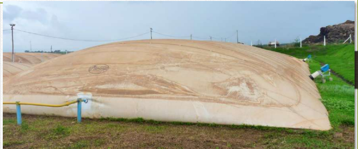
Figura: Biodigestor tipo lagoa coberta com agitação para tratamento de efluente suíno e produção de energia elétrica a partir de biogás. Patos de Minas, MG. 2017.
