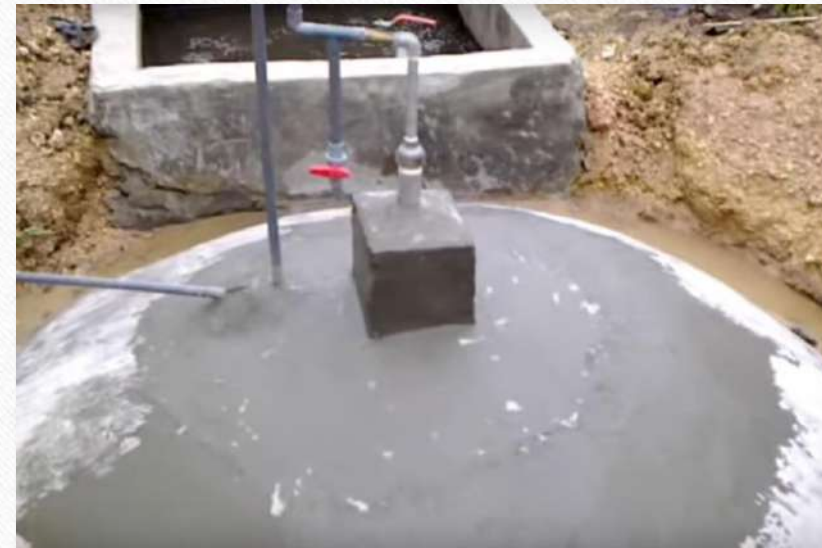
Figura: Biodigestor de cúpula fixa modelo “Chinês” para tratamento de esterco bovino e geração de biogás.
