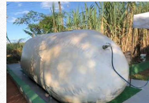
Figura: Gasômetro tipo „balao“ no BiogasLab IFG-UFG.
